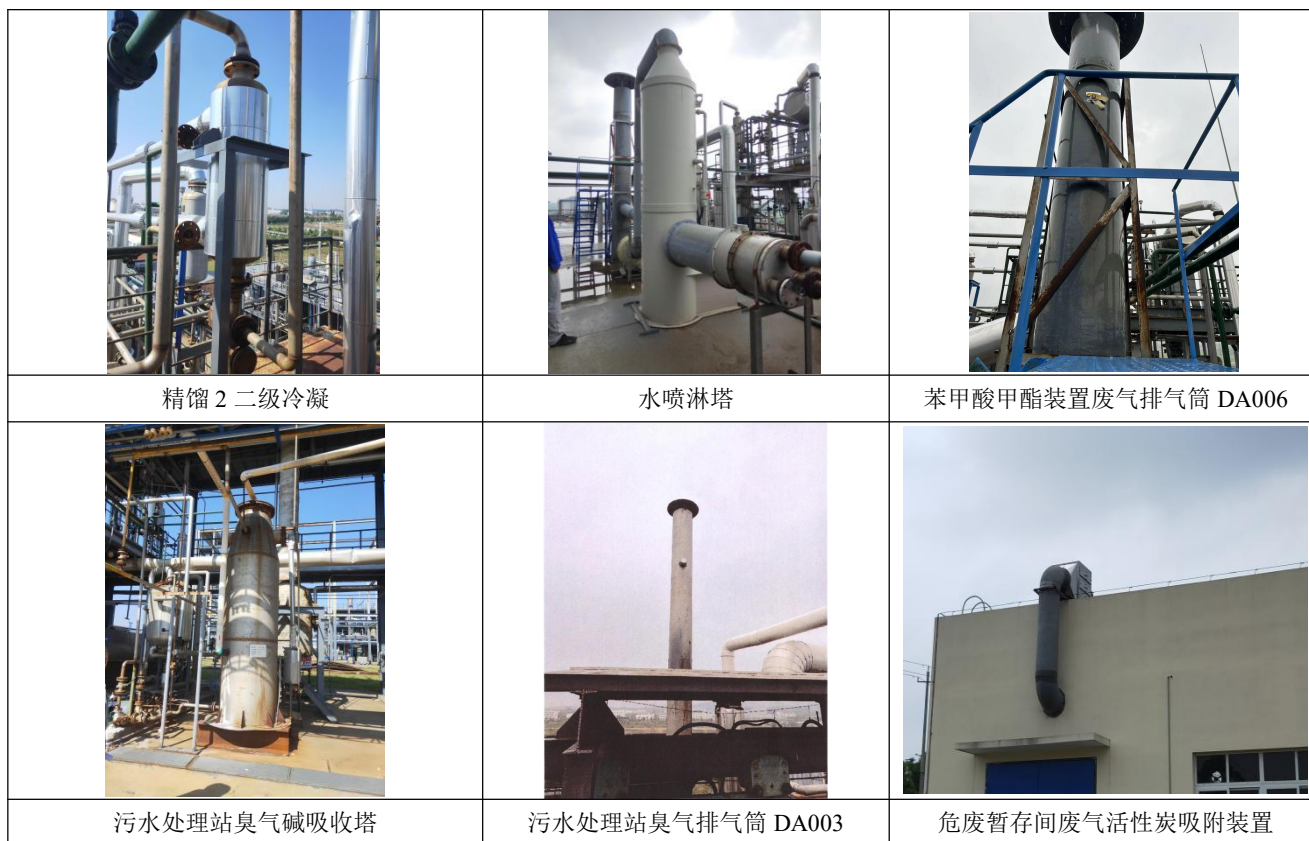
图 4.1-5 项目废气收集处理措施图
